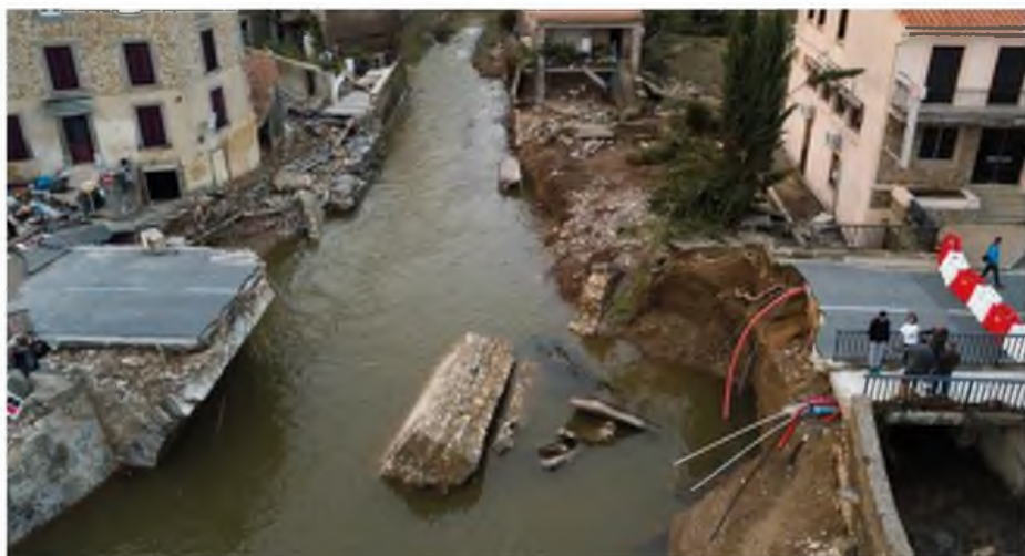
Inondations à Villegailhenc le 15 octobre 2018 suite à la crue du ruisseau de Trapel © Sébastien Gominet - IRMA
