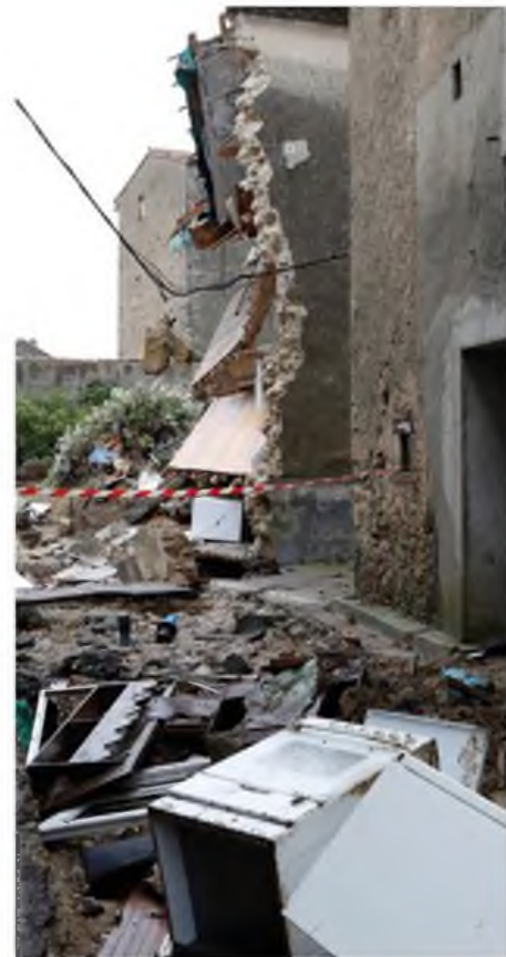
Inondations à Villegailhenc le 15 octobre 2018 - Dégâts rue de la mairie © Sébastien Gominet - IRMA
